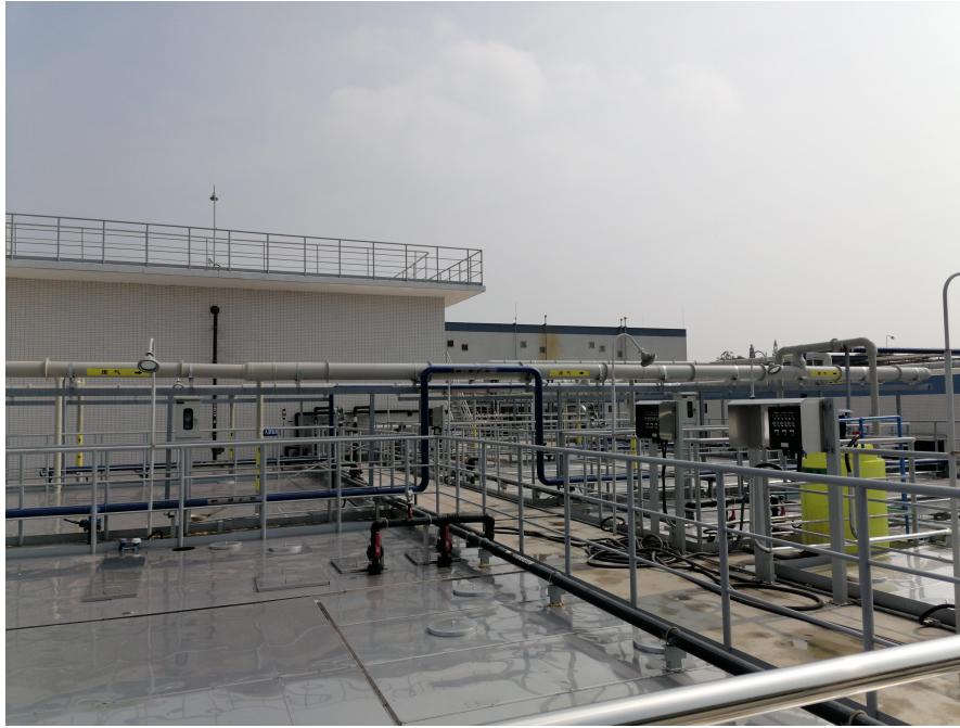
图 3-3 污水处理站 2（新建）
